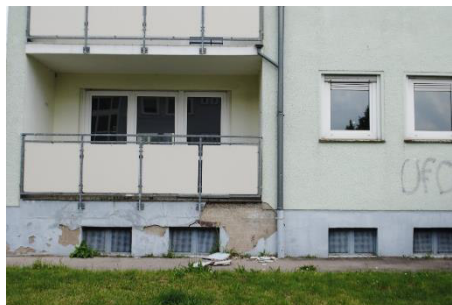
Abbildung 35: Mangelhafte Bausubstanz der Mehrfamilienhäuser in der Adenauerstraße
